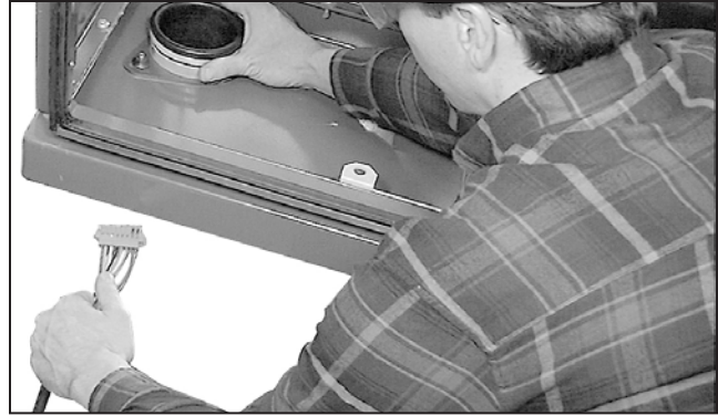
Figura 62. Inserción de los cables en el gabinete de baja tensión a través de los tubos y conductos.
