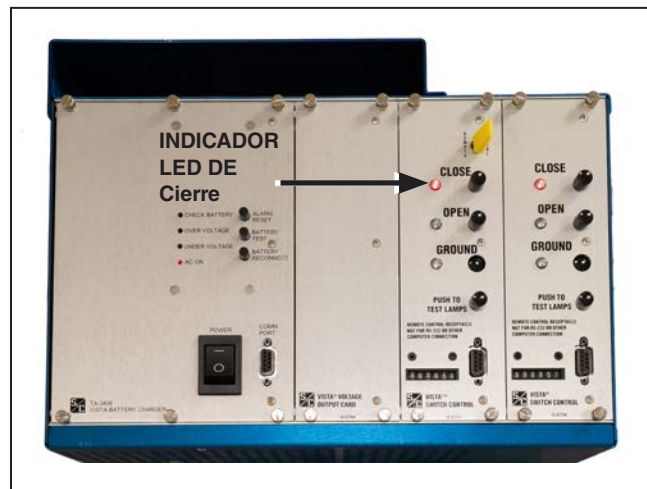
Figura 102. La indicación CLOSE (Cerrado) en el tablero de control del motor coincide con la posición del moto-operador.
