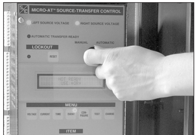
Figura 44. El seccionador MANUAL/AUTOMÁTICO del control de transferencia de fuente Micro-AT.
