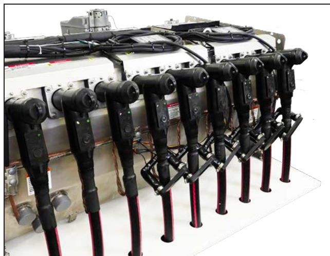
Figura 113. El cableado está sujeto a los sensores de corriente.
