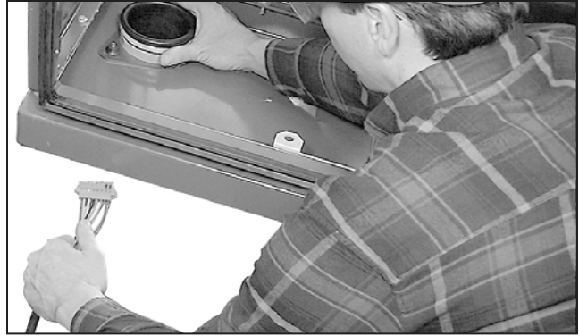
Figura 120. Inserción de los cables en el gabinete de baja tensión a través de los tubos y conductos.
