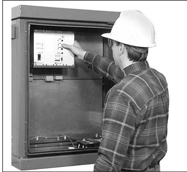
Figura 106. Un gabinete de baja tensión estilo bóveda mostrado con los aditamentos para una unidad terminal remota y comunicaciones.
