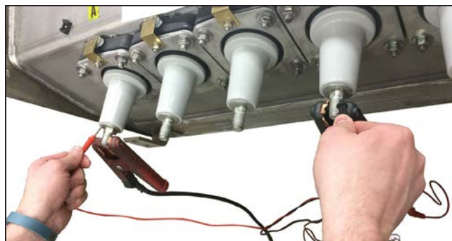
Figura 138. Conectando el dispositivo de medición de la resistencia.●
