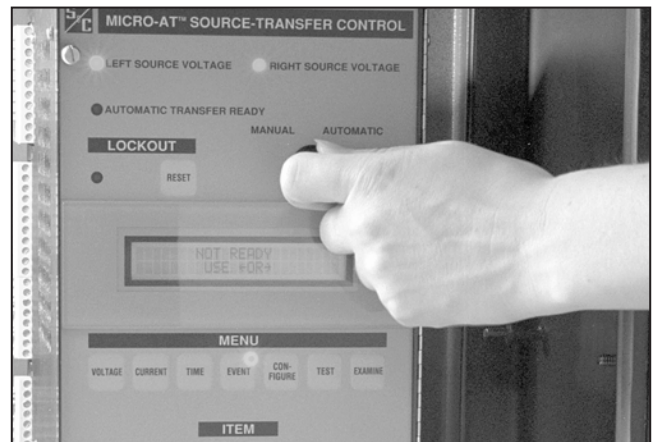
Figura 104. El seccionador MANUAL/AUTOMÁTICO en el Control de Transferencia de Fuente Micro-AT.
