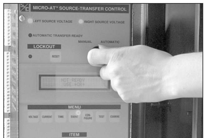
Figura 74. El seccionador MANUAL/AUTOMÁTICO del Control de Transferencia de Fuente Micro-AT.
