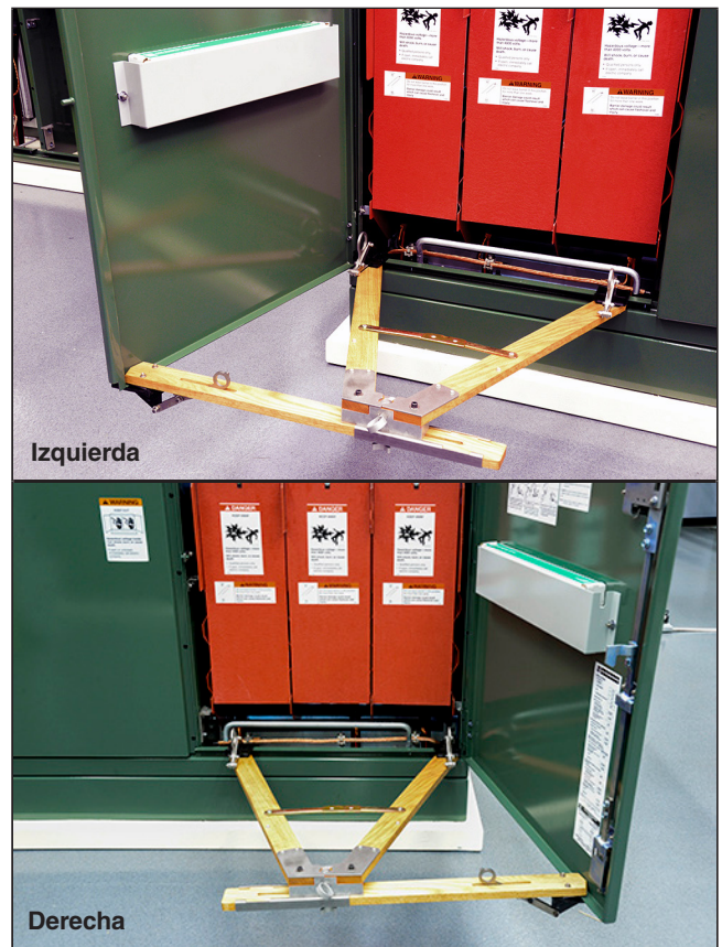
Figura 2. La Herramienta para Fusibles FlexiPull puede ser instalada en la puerta derecha o en la puerta izquierda del compartimento.
