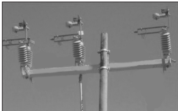
Figura 16. Verificación de que las navajas del interruptor están a 90 grados de la posición de cierre.
