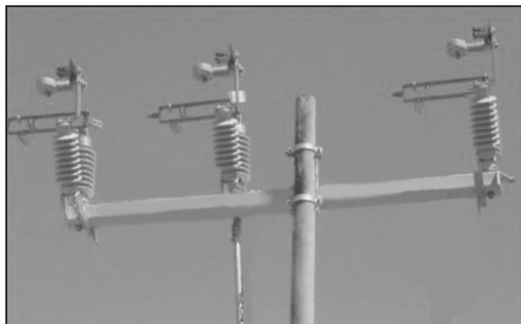
Figura 30. Verificación de que las navajas del interruptor están a 90 grados de la posición de cierre.
