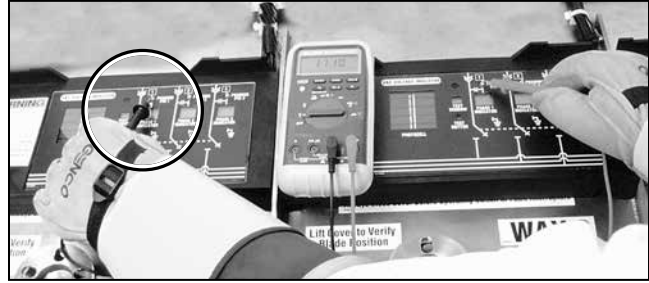
Figura 53. Midiendo el voltaje fase a fase—Fase 1 a Fase 1.
