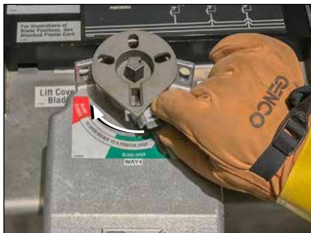
Figura 20. Al girar el selector de operación al extremo izquierdo, permitirá operar a la posición aterrizada.
