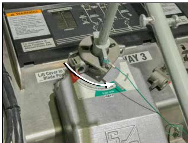
Figura 21. Conexión a tierra del seccionador interruptor de carga (o interruptor de falla).
