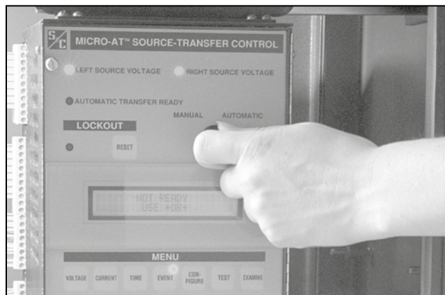
Figura 27. Interruptor MANUAL/AUTOMÁTICO del controlador Micro-AT.
