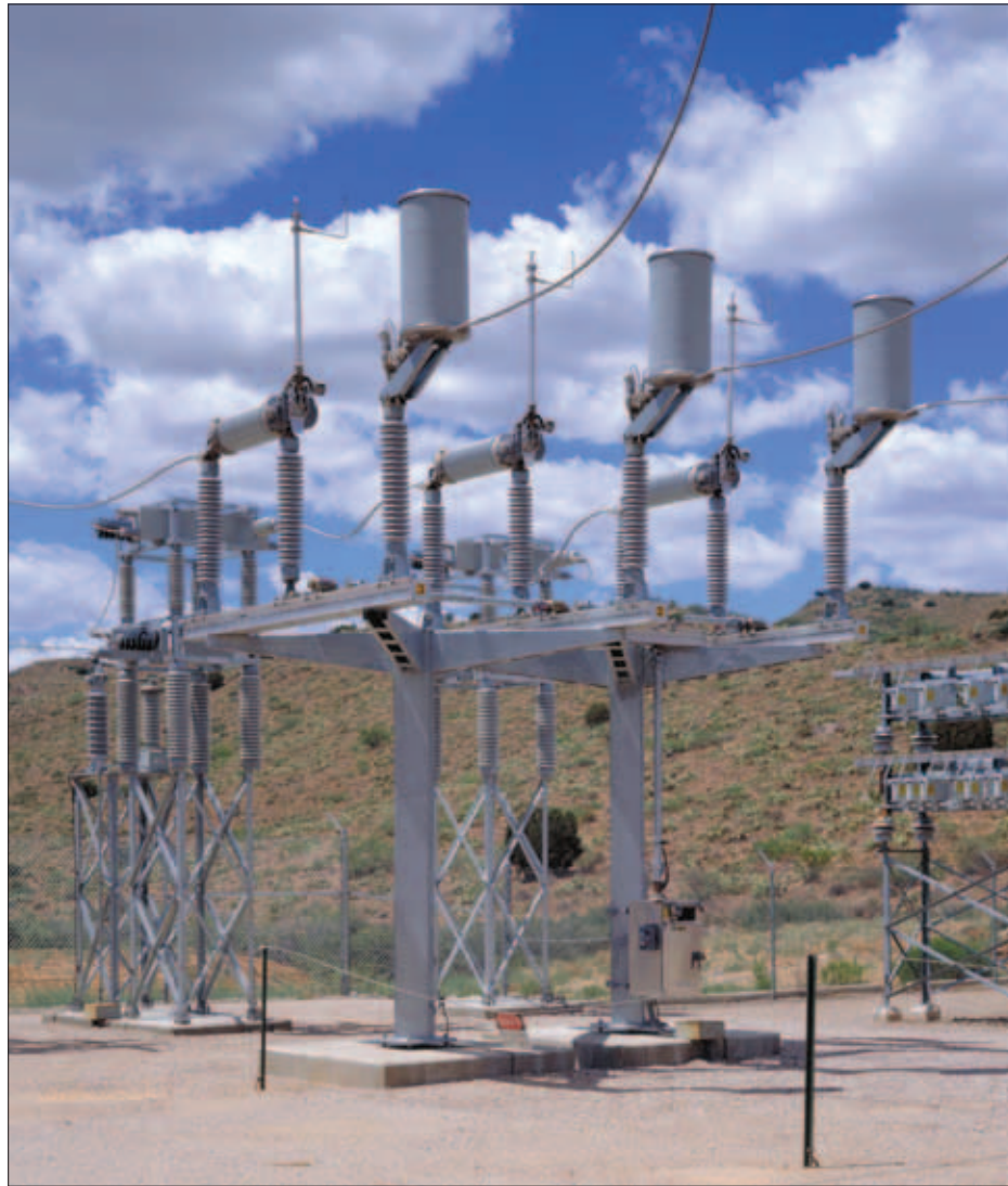
Inductores de inserción previa empotrados en un Circuit-Switcher Modelo V Estilo con Apertura Vertical con capacidad de 138-kV.
