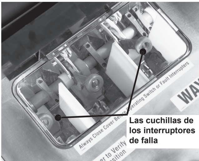
Los interruptores de falla se muestran en la posición de abierto... los cables ahora están aislados.
