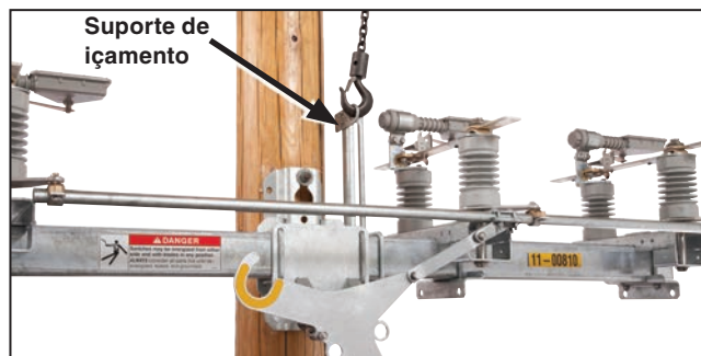
Figura 4. Içamento da Chave Omni-Rupter até a posição. Exemplo para a configuração de montagem horizontal
