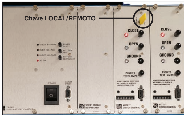
Figura 26. Rack de controle dos operadores motorizados.
