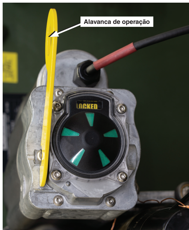
Figura 19. Bascule a alavanca de operação amarela na direção oposta ao transformador para a posição Aberta e Travada. A operação automática é desabilitada.
