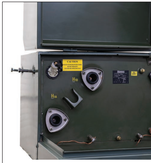
Figura 5. Buchas tipo poço com insertos de interrupção sob carga removidos.
