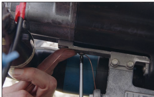
Figura 37. Ponto de aterramento no interruptor para bucha tipo poço.
