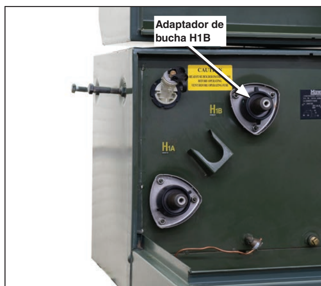
Figura 7. Adaptadores de buchas tipo poço instalados.
