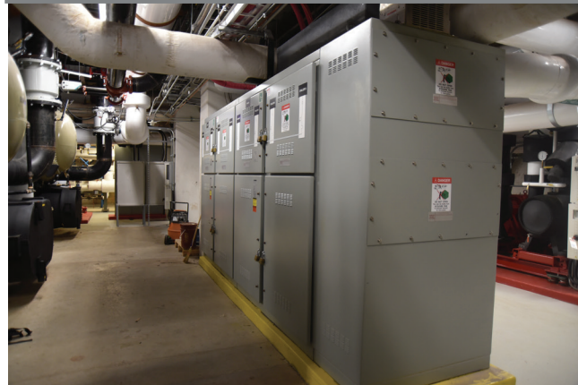
Figura 2. A instalação do Painel System VI concluída no local apresentando restrições.
