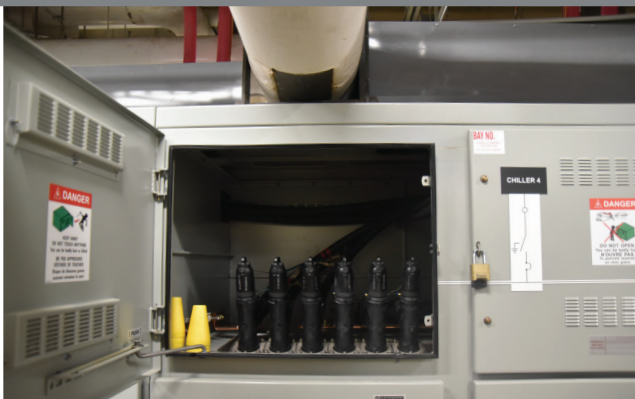
Figura 1. Vista da instalação do Painel System VI, com uma tubulação restringido a altura em 86 polegadas (218 cm).
