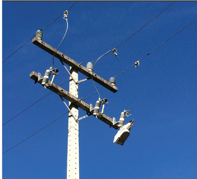
Religador TripSaver II instalado no Estado do Paraná.
