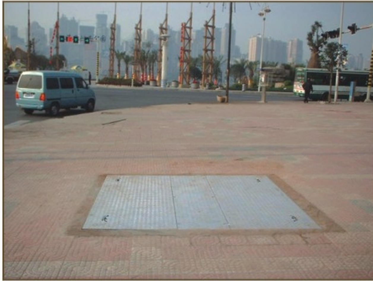
Vista地埋式环网柜在中国城网改造中的应用
