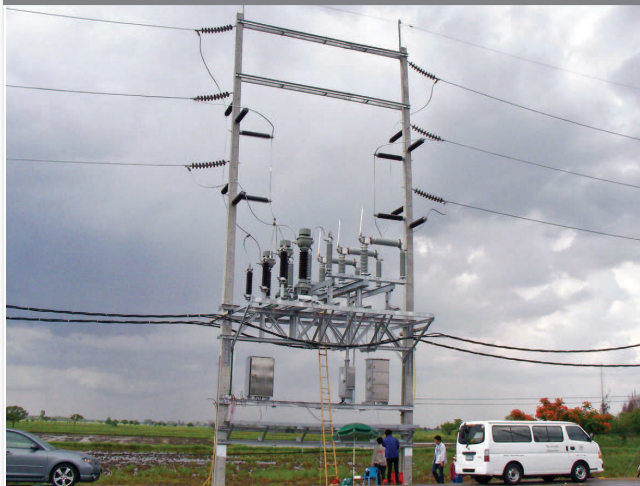
Figura 1. Estación de conmutación mediante Circuit-Switcher Serie 2000.
