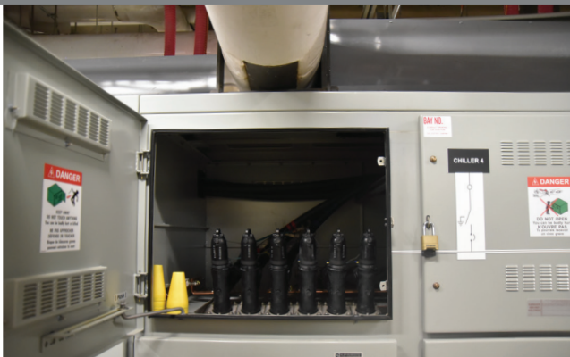
Figura 1. Un acercamiento de la instalación del Tablero de Distribución System VI, donde un tubo restringió la altura del equipo a 86 pulgadas (218 cm).
