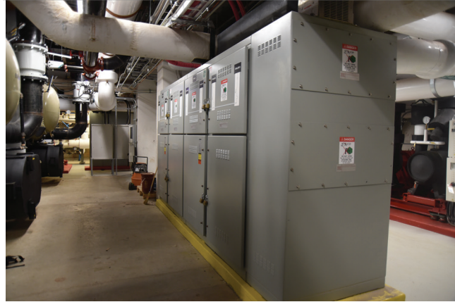
Figura 2. La instalación completada del Tablero de Distribución System VI en el lugar restringido.
