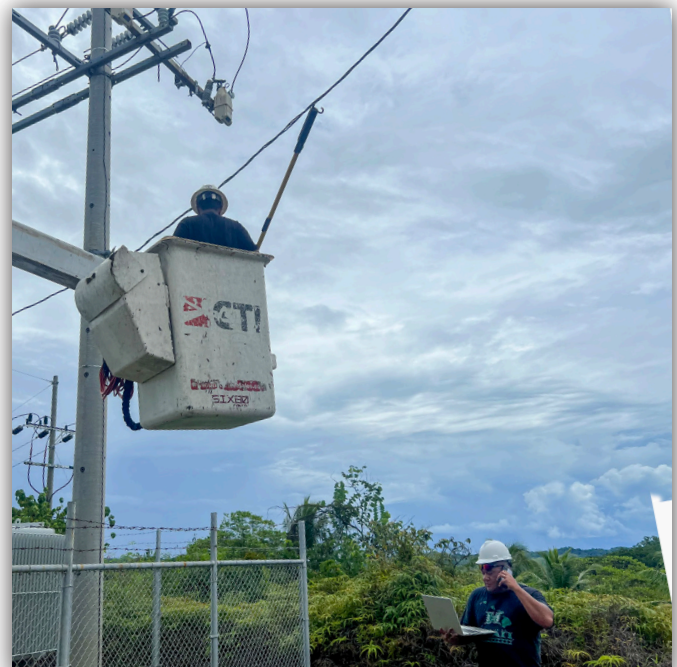
FIGURA 3. Reconectores TripSaver II instalados en la red de PPUC.
