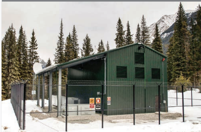
El Sistema de Almacenamiento de 1-MW de BC Hydro Terminado en la Subestación de Field.
