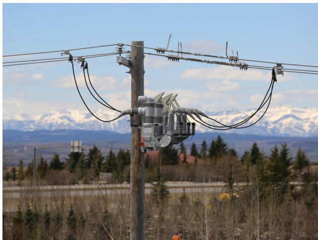
Figura 1. Uno de los Interruptores de Fallas IntelliRupter® PulseCloser® desplegados por ENMAX para abordar las interrupciones momentáneas.
