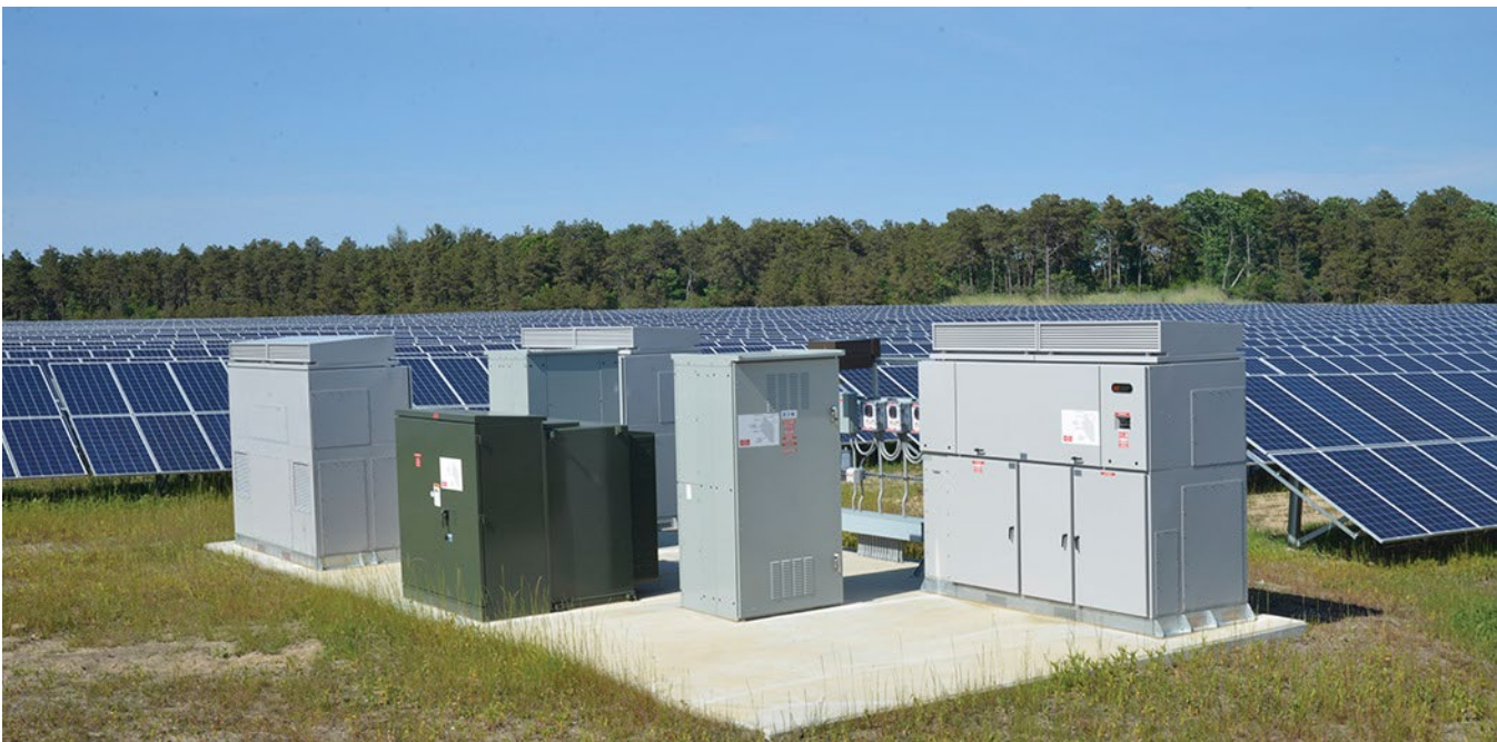
Una vista de la planta de energía solar terminada con el equipo de interconexión.
