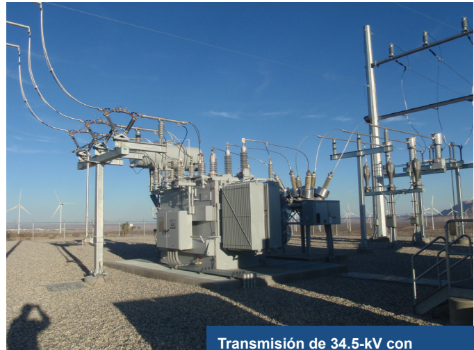
Transmisión de 34.5-kV con transformador de 100-MVA.
