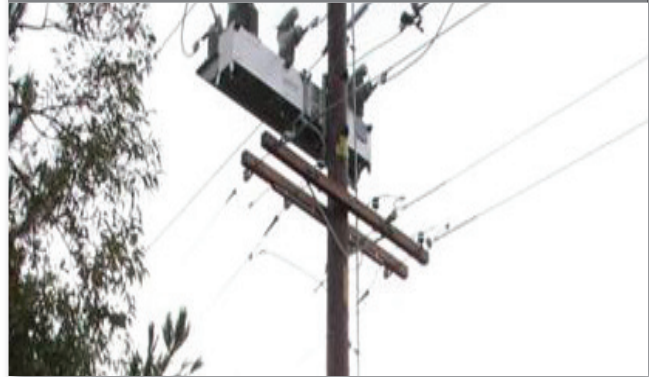
Radio en malla SpeedNet con antena montado sobre un poste del servicio público.
