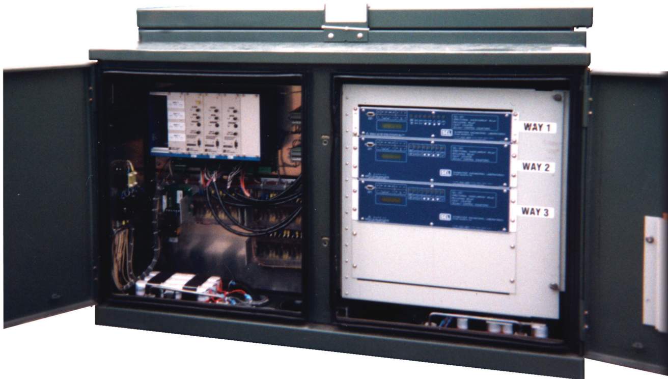
Figura 2. SEL-351 Relevadores SEL-351 contenidos en un compartimiento para baja tensión del Interruptor Vista.
