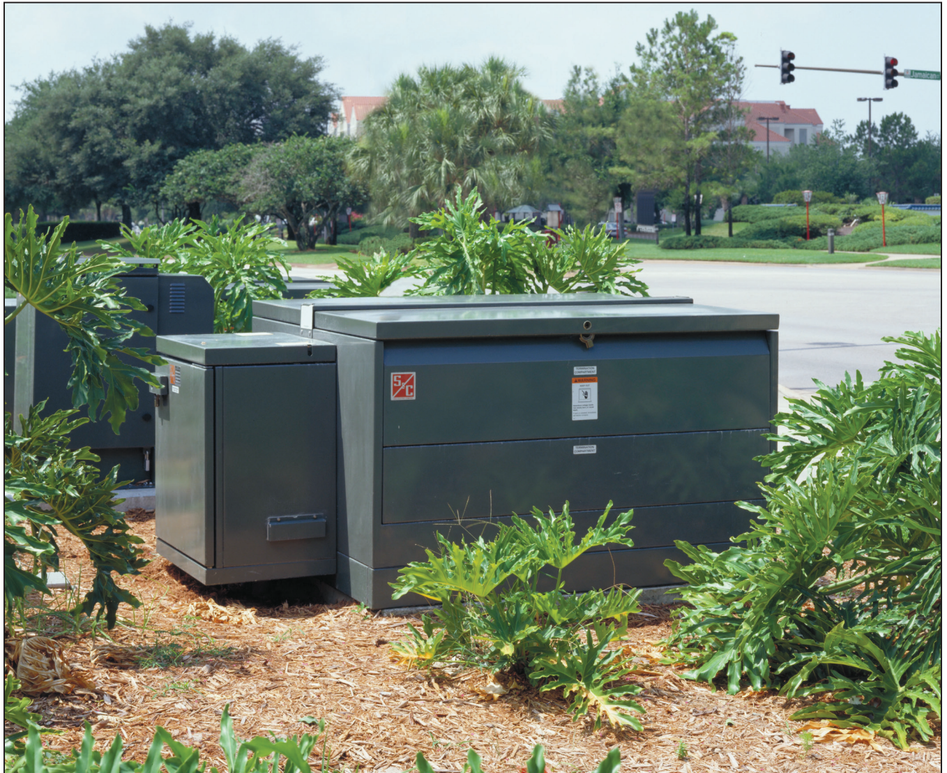
Figura 1. Interruptor de Distribución Subterránea Vista con Supervisión Remota.
