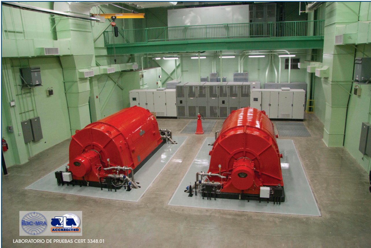
Cuarto de Generadores
