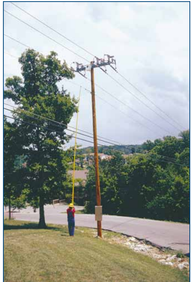
Apariencia limpia y ordenada . . . incluye sensores, fuente de alimentación y una cuchilla desconectadora trifásica.
