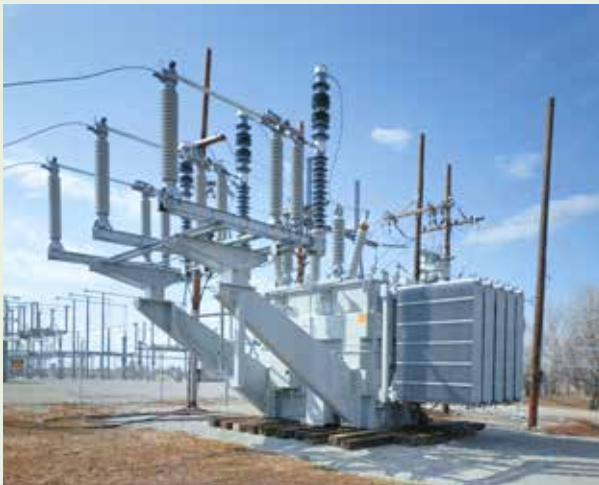
FIGURA 6. Un Protector de Transformadores Trans-Rupter II Modelo SE con capacidad de 138 kV montado sobre un transformador en una instalación temporal sobre los durmientes de una vía férrea.
