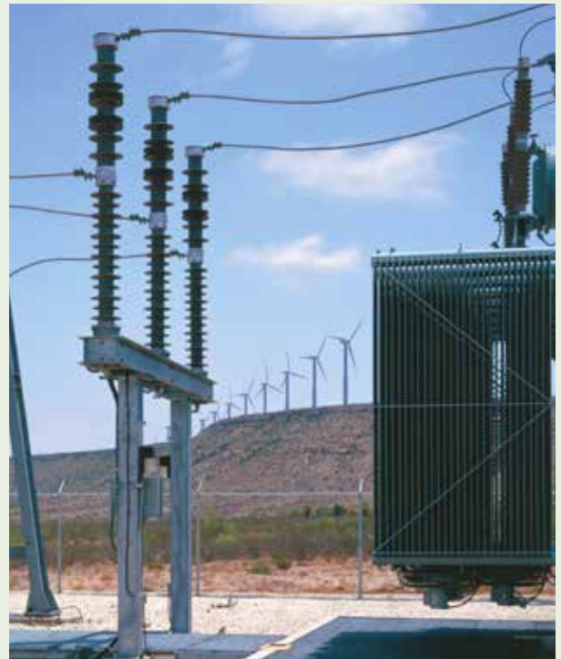
FIGURA 3. Un Modelo EX para proteger una subestación eólica.
