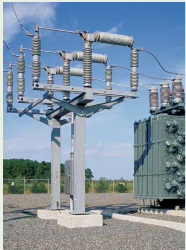
FIGURA 1. Un Circuit-Switcher Serie 2000 Modelo 2010 de 138 kV con cámaras interruptivas horizontales y una cuchilla desconectadora de apertura vertical.
