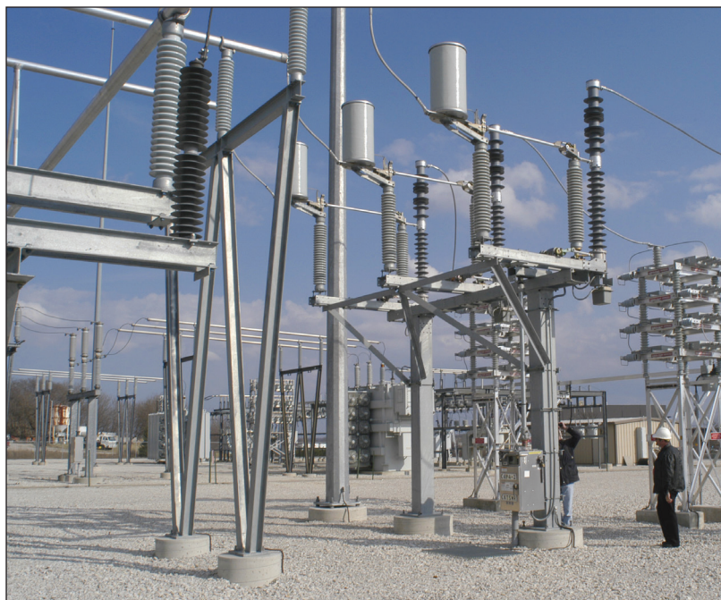
Circuit-Switcher Mark VI de 138 kV instalado sobre Pedestales de Montaje de S&C.
