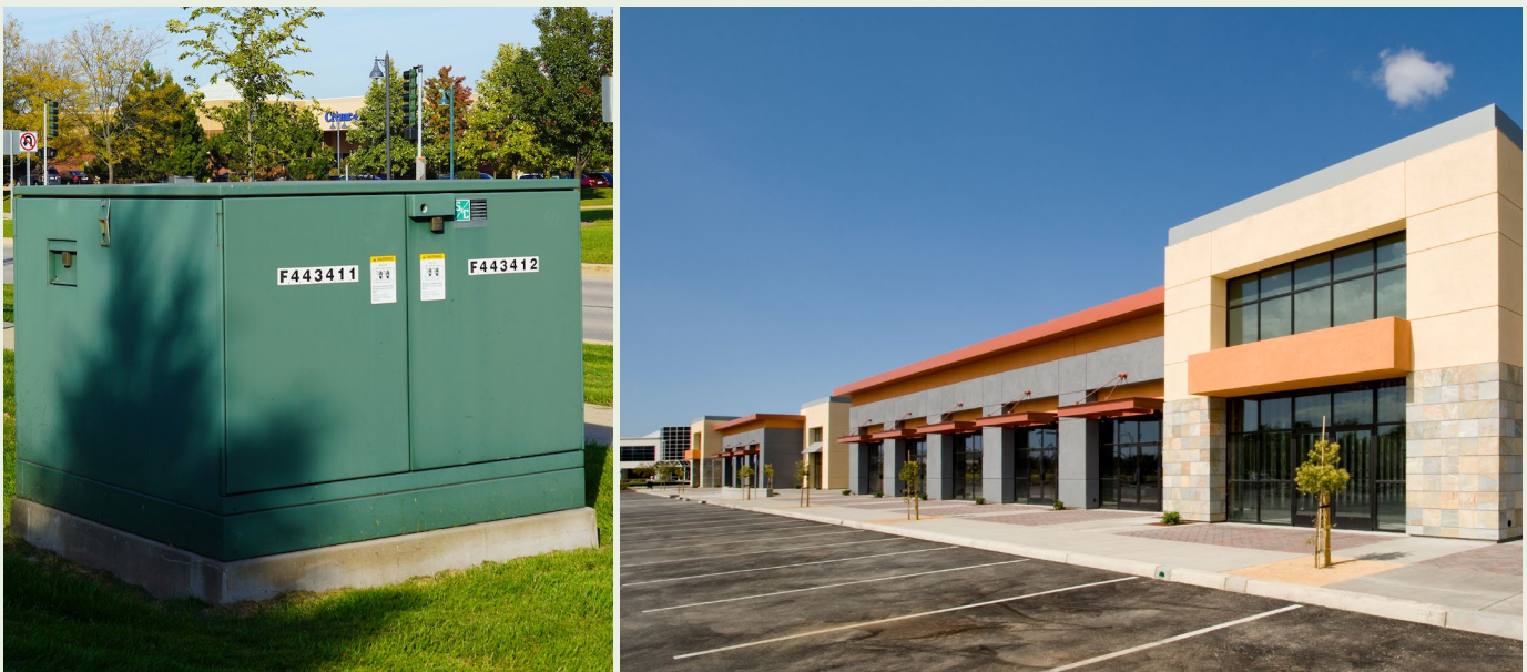
FIGURA 6. Este gran centro comercial suburbano recibe el servicio de siete unidades de equipos montados en pedestal en dos circuitos primarios en anillo. En los centros de seccionamiento de entrada de servicio primario selectivo se aplican dos alineaciones de gabinetes tipo metal-enclosed, para el seccionamiento de los extremos de los anillos.
