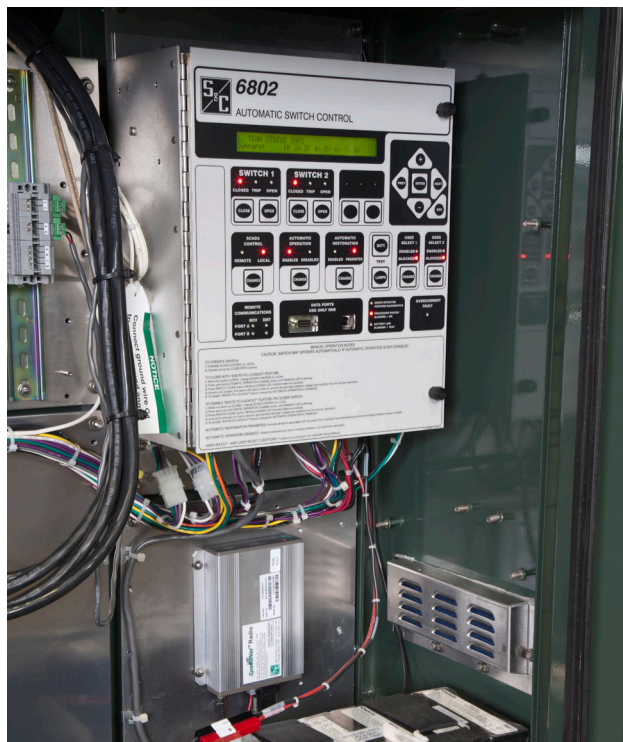
Control Automático de Interruptor 6802.
