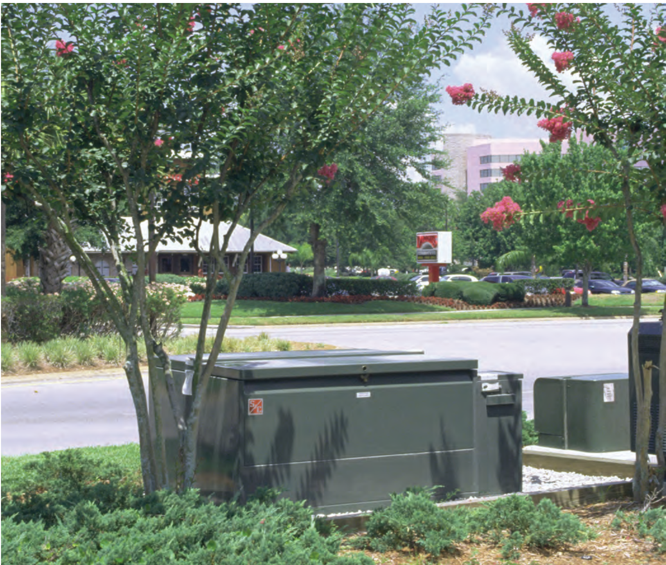
Instalação de Painel Vista Supervisão Remota em Estilo Pad-Mounted.
