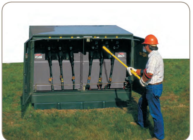
Figura 3. A operação de um painel dead-front típico pode ser desajeitada e demorada.
