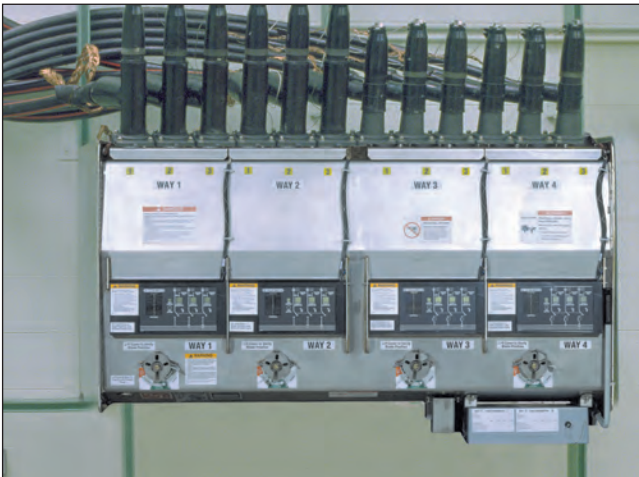
Estilo Vault-Mounted - disponível para montagem no chão ou na parede.
