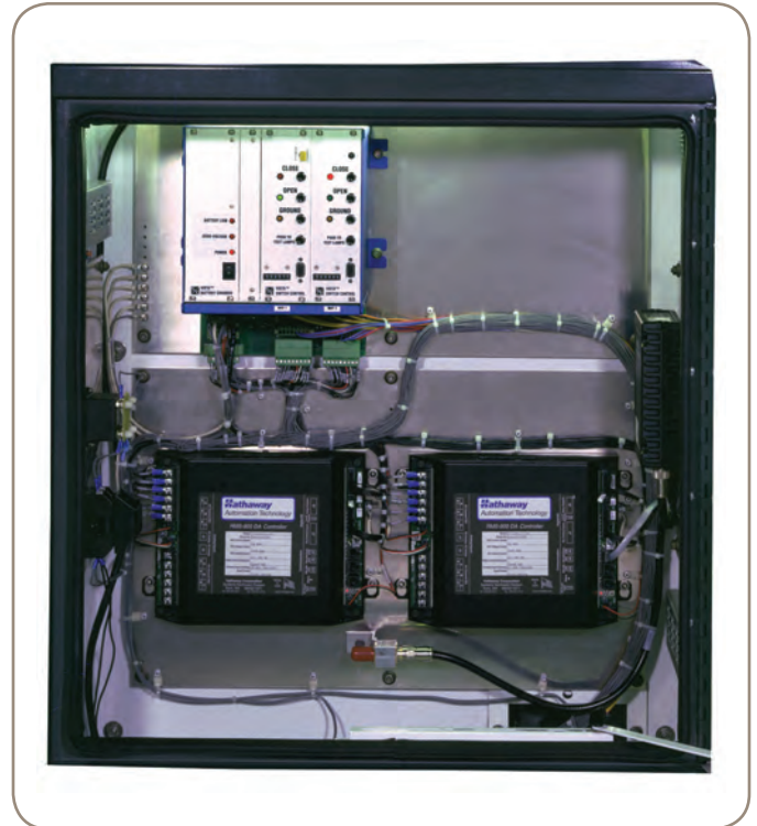
Detalhes do compartimento de baixa tensão do Painel Vista Supervisão Remota Modelo 422.
