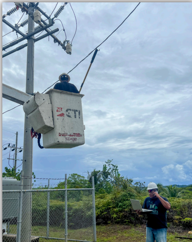
FIGURA 3. Instalação de religadores TripSaver II na rede da PPUC.
